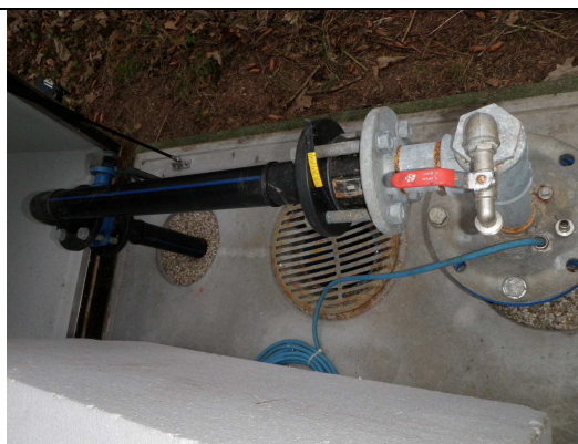
Figur 2: Viser råvandsstationen til DGU nr. 54.341
