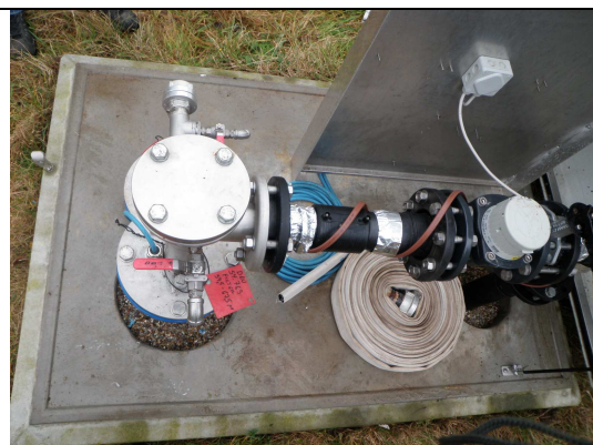
Figur 1: Viser råvandsstationen til DGU nr. 54.763
